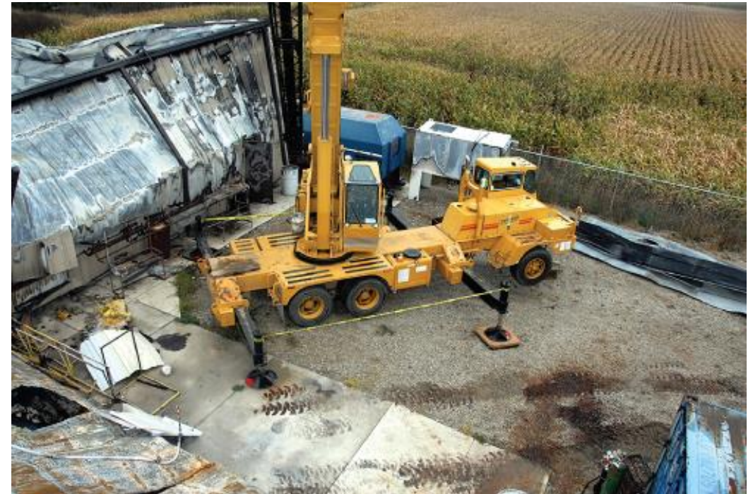
Figura 13.4.2 El radio de giro de la grúa se protegió correctamente.
