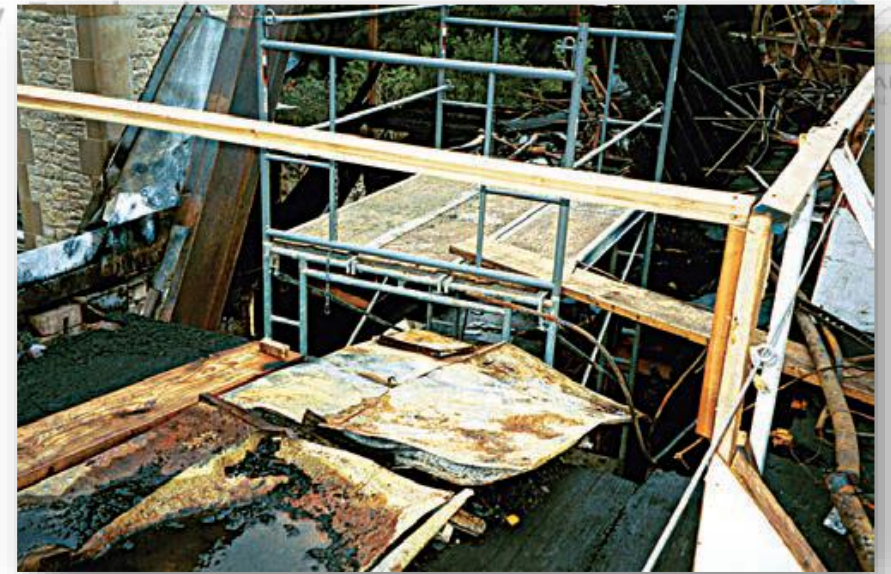
FIGURA 13.3.1 Andamio utilizado por los investigadores para acceder a partes de la estructura. El riesgo de caída está en la pasarela entre el andamio y la estructura.
