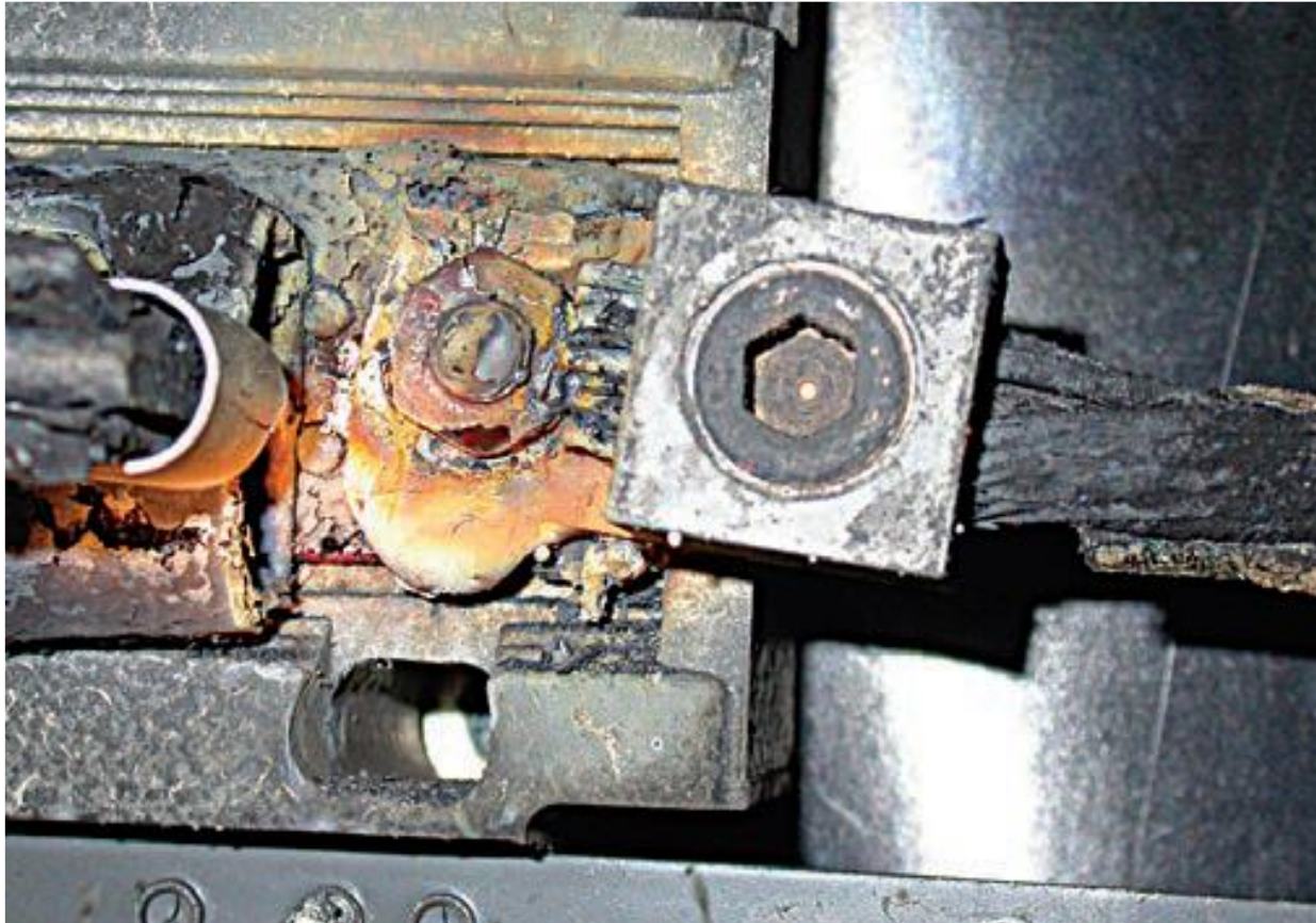
FIGURA 9.10.4(a) Conexión sobrecalentada en un terminal de fusibles trifásico a 208 V.
