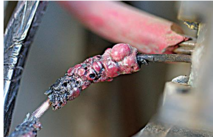
FIGURA 9.10.5.1(a) Cubierta de conductor de cobre de 120 V #14 AWG, conectado a un disyuntor de 50 A.
