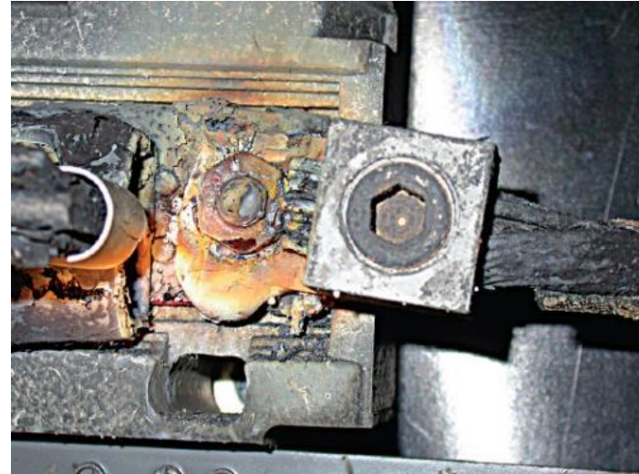
FIGURA 9.10.4(a) Conexión sobrecalentada en un terminal de fusibles trifásico a 208 V.
